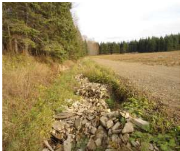
Photo 23: Érosion du fossé du chemin de ferme au nord du site.
